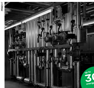
Управление насосной станцией
